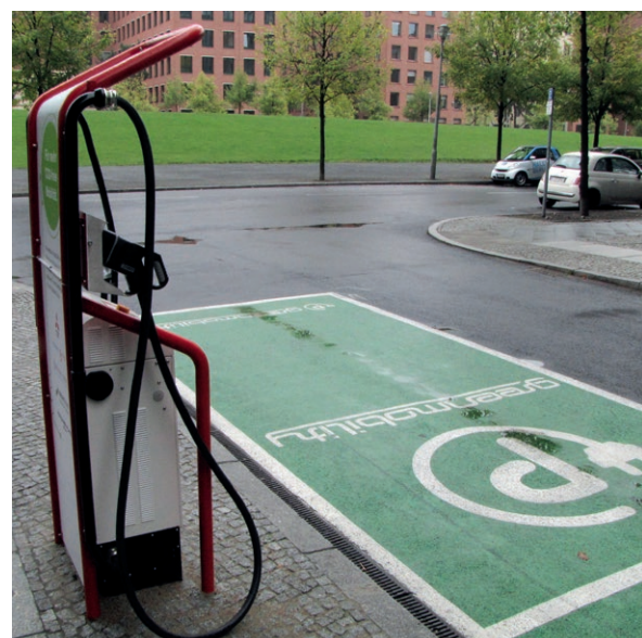
Bild 2: Markierung einer Ladestation
