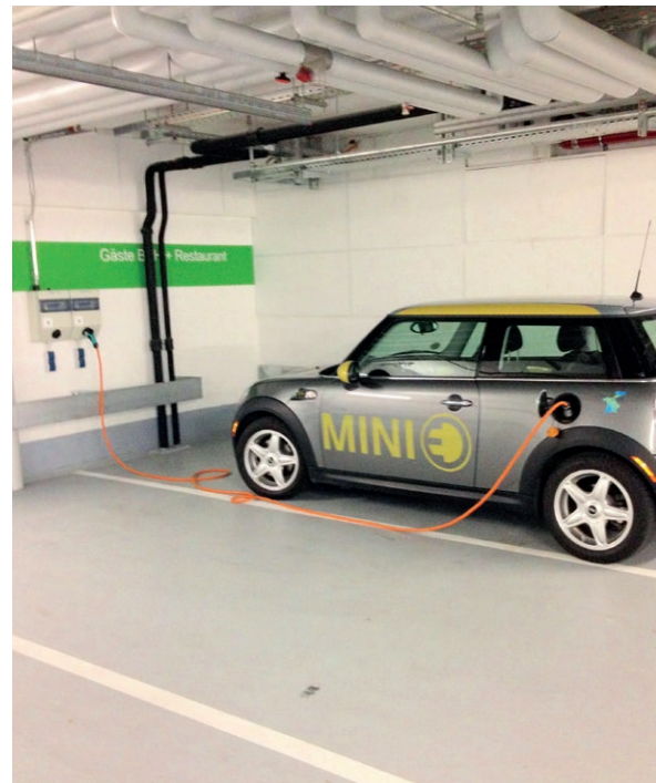
Bild 3: Ladestation in einer Garage
