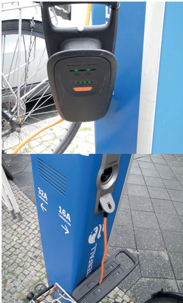
Bild 4: Ladeleitung im Einsatz
